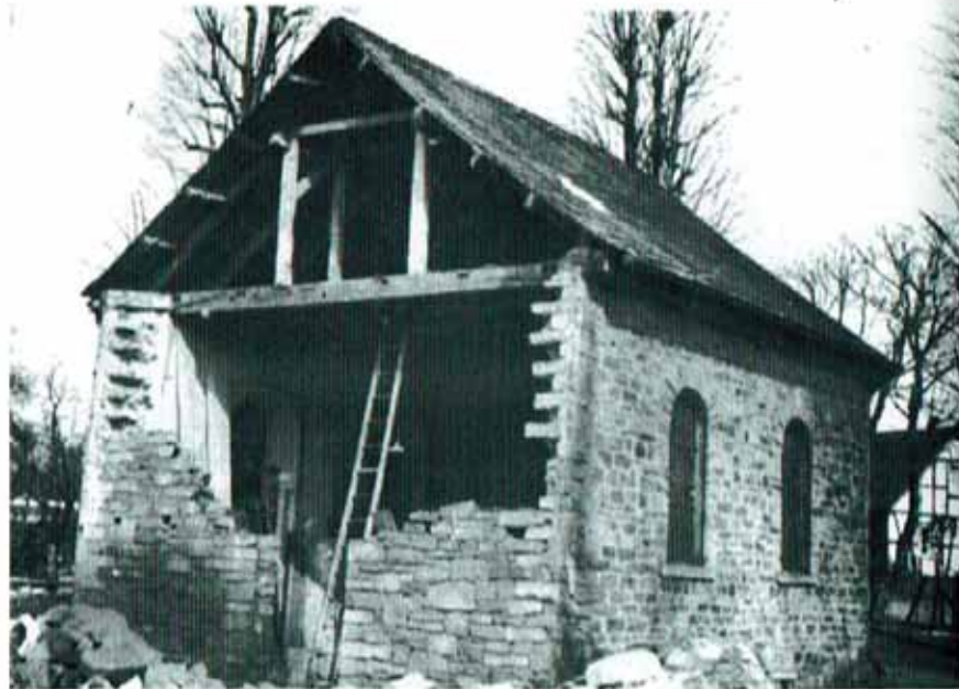
Stand der Bauarbeiten an der Giebelwand, als die Arbeiten eingestellt werden mussten
