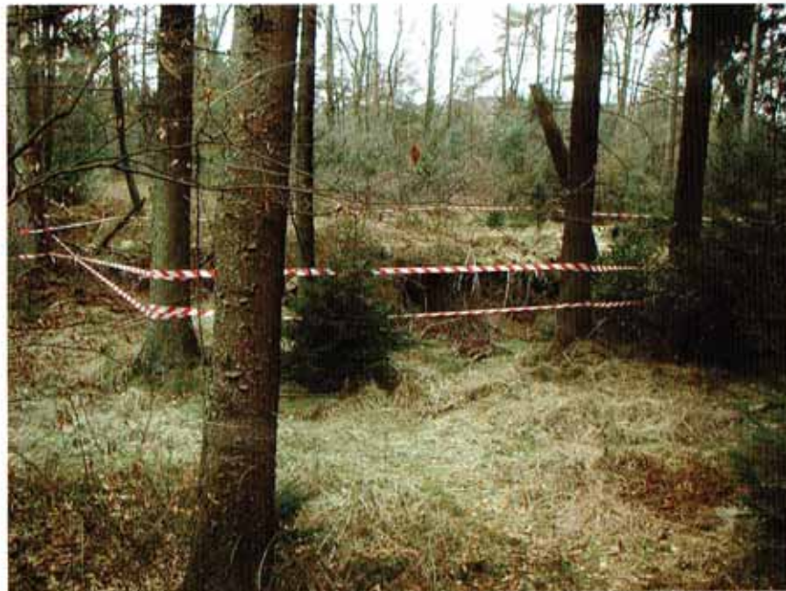
Der Tagesbruch ist mit Warnband abgesperrt. Die steilen Ränder brechen mit Nachlassen des Frostes nach. Ein Betreten dieses Bereichs ist mit unkalkulierbaren Risiken verbunden.
