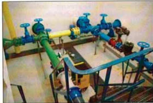
Der Hochbehälter in Oberhasbach fasst 2000 m³. So sieht das Innenleben aus, die Schieberkammer.
